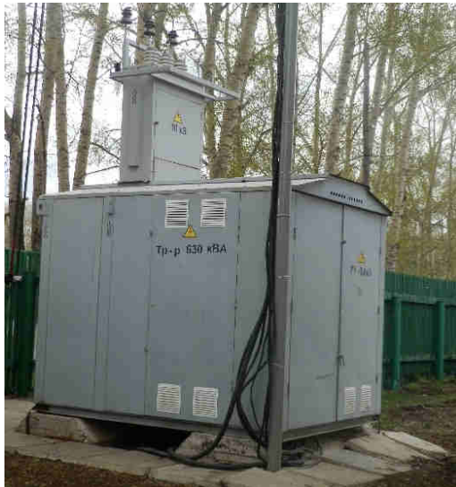
КТПн в металлическом корпусе
