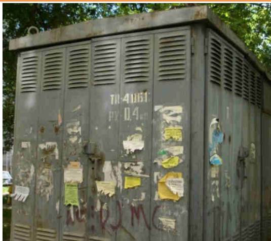
КТПН в металлическом корпусе
